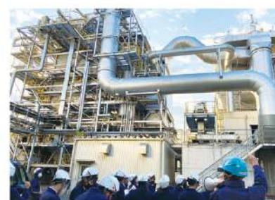
バイオマス発電所
